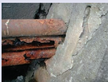
図1 腐食状況(橋台際)
