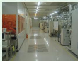
写真1 クリーンルーム
