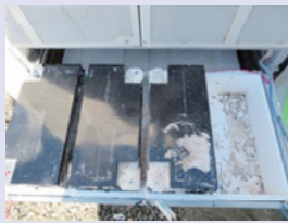
(a) RSBM-F (屋外設置型)の被害状況
