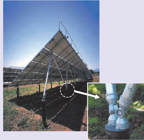
図6 モジュールを支持する架台
