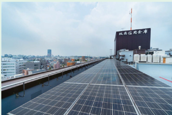
写真2 城南信用金庫本店の屋上に設置されている太陽光発電パネル
