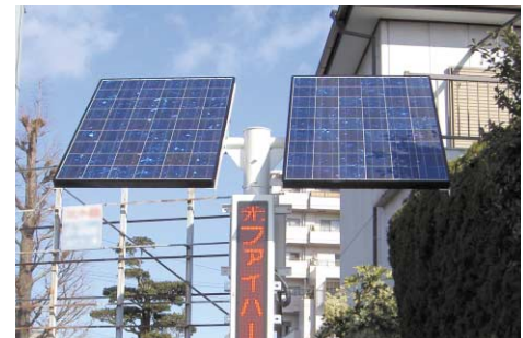
太陽光発電システム
